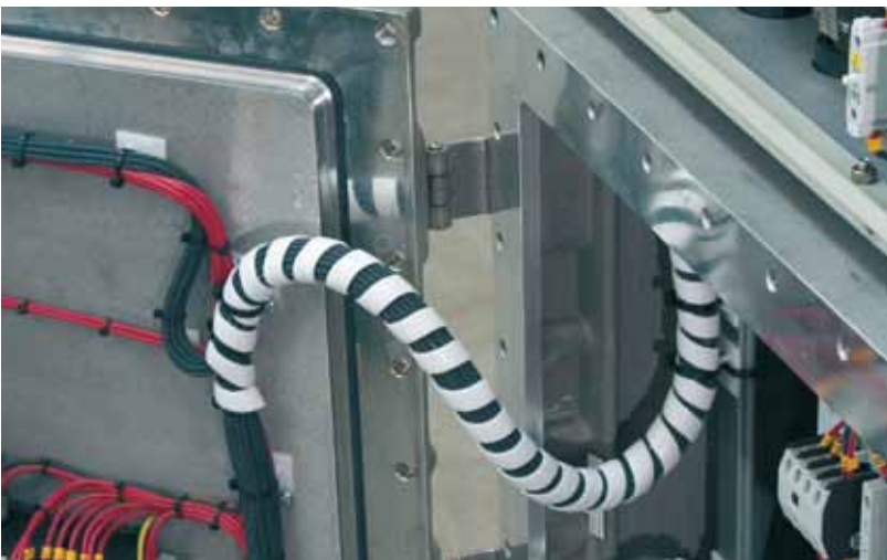
Bild 2: Kabel und Leiter sind vor mechanischer Beschädigung geschützt
