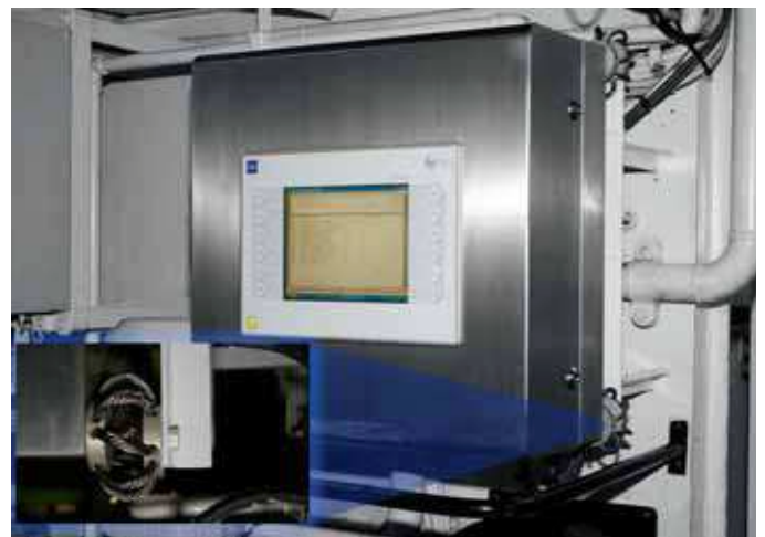
Bild 3: Das explosionsgeschützte HMI im Maschinenraum unterstützt die vernetzte Datenkommunikation und ermöglicht zudem bequeme Vor-Ort-Bedienung.
